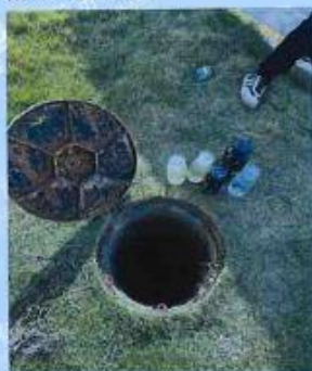
生活污水排放口
