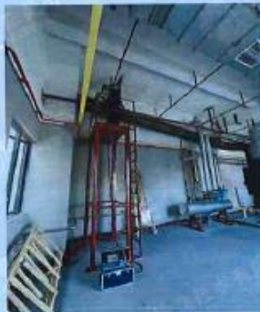
燃天然气废气排放口
