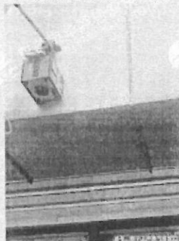
涂布、烘干工序废气排放口
