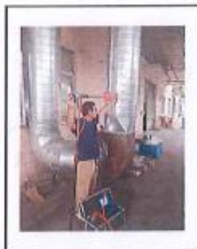
抛光工序废气排放口
